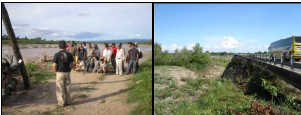
Imagen 11 y 12: descartes de la actividad ripiera en el lecho del Río Blanco y vanos del puente obstruidos.
