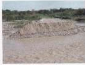
Foto 1. Tomada hacia el Sur. Abertura practicada en el terraplén para permitir el paso del río Blanco. El agua fluye desde la derecha hacia la izquierda de la foto.
