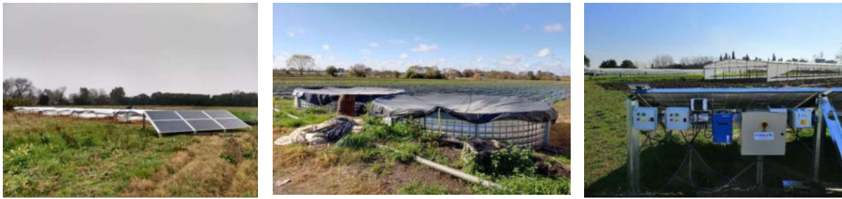
Figura 4: sistema de reservorios y bombeo solar instalado en la localidad de Florencio Varela. A la izquierda se observan los 6 paneles solares que alimentan a la bomba sumergible. En medio los reservorios conectados entre sí. A la derecha la vista general del sistema eléctrico, paneles solares y control de bomba solar. De fondo los invernaderos para la producción hortícola y a campo. Fuente: Elaboración propia.
