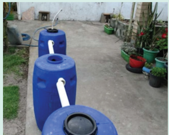
Figura 11: Parte del tratamiento anaeróbico del sistema de tratamiento de aguas grises.
