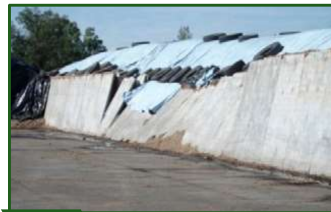
Figura 10-42 Cuando se utilizan estructuras de cemento es importante controlarlas periódicamente para corroborar que se hallan en buen estado.
