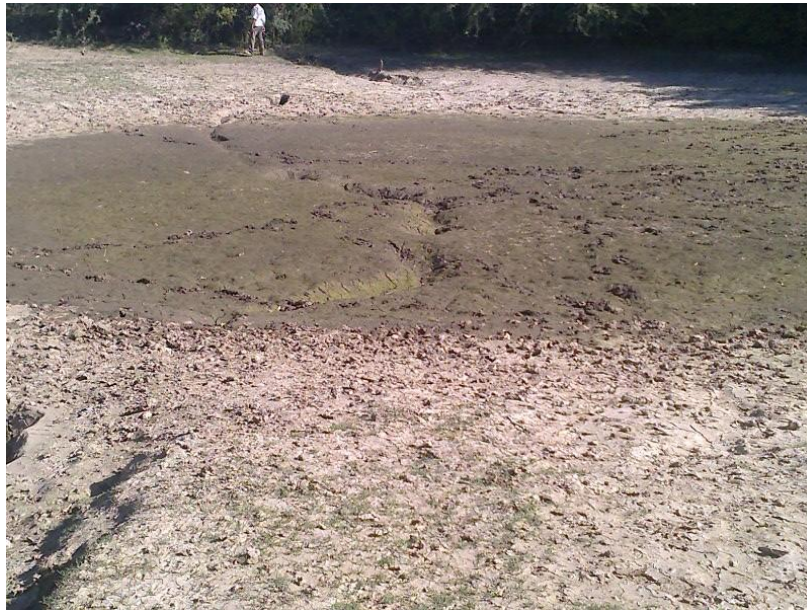
Foto 2.- Vista de la represa aún húmeda y la grieta que la atraviesa.
