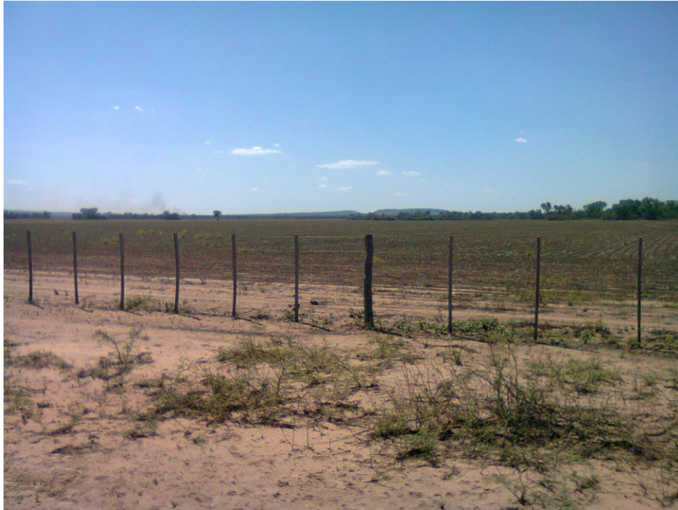
Foto 3.- Vista de una grieta en el margen del camino y alambrado de lote con desmonte extendido.
