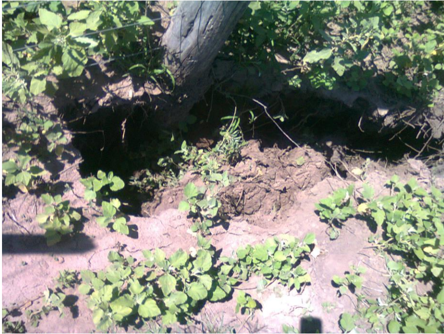
Foto 5.- Vista de grieta crecida bajo poste de alambrado del lote desmontado recientemente, referenciado en las imágenes y carta topográfica, tramo lindero sur.
