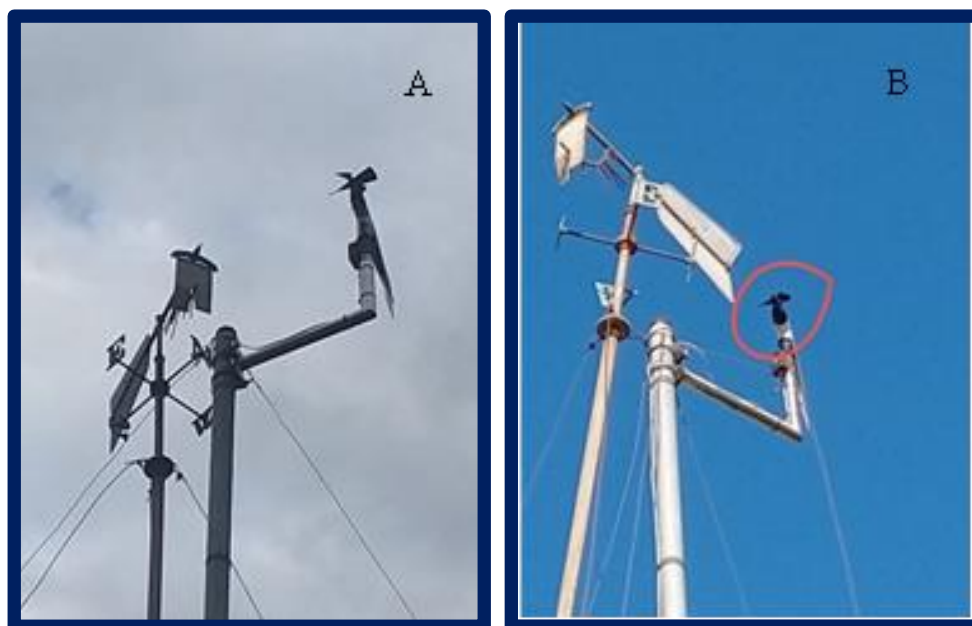
Figura 10. Estado del anemómetro previo (A) y posterior (B) a la tormenta.
