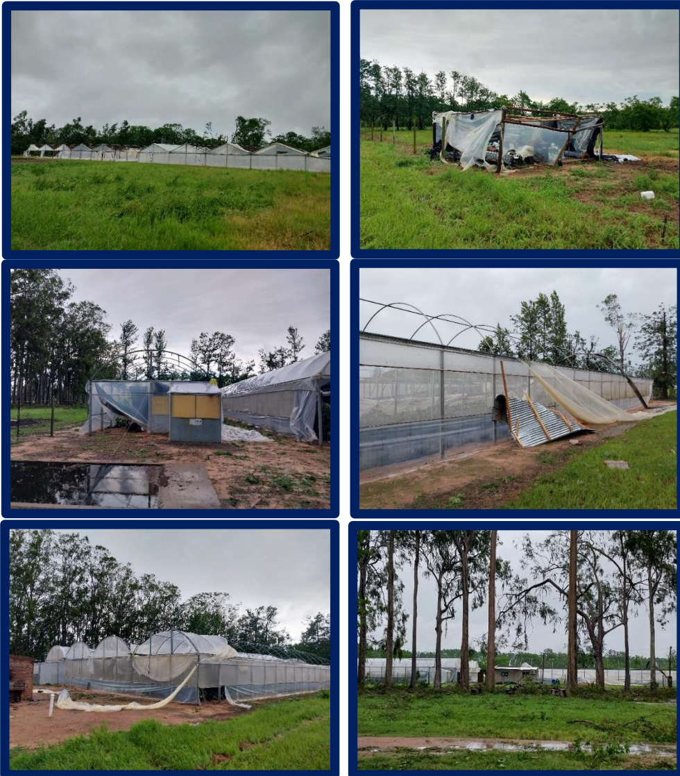
Figura 11. Daños causados por la tormenta del 29 de diciembre de 2023 en los invernáculos de producción hortícola (fotos superiores), y en las estructuras del banco yemero cítrico.
