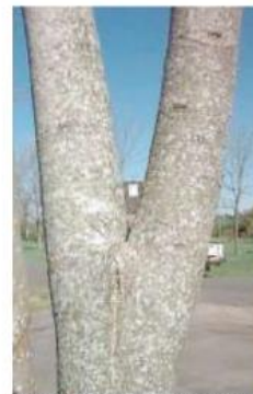
Unión débil en "V" con una fisura potencial y corteza incluida.
