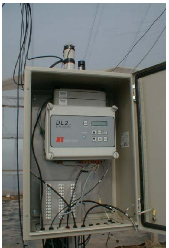
Figura 1.2.3. Data logger y sensor de radiación global (arriba a la derecha)
