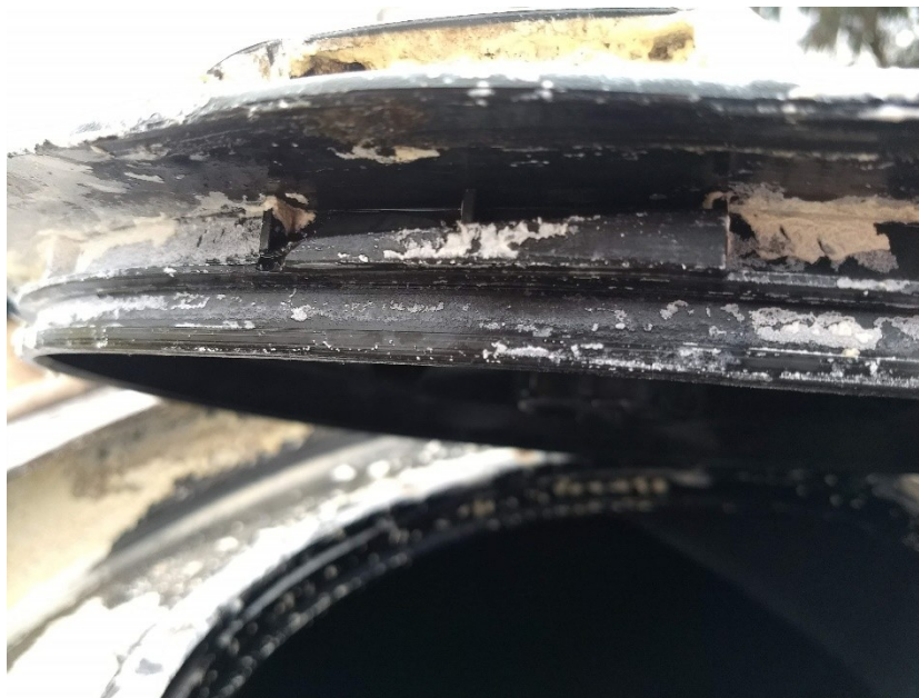
Figura 3. Detalle de tapa del depósito sin anillo de goma
