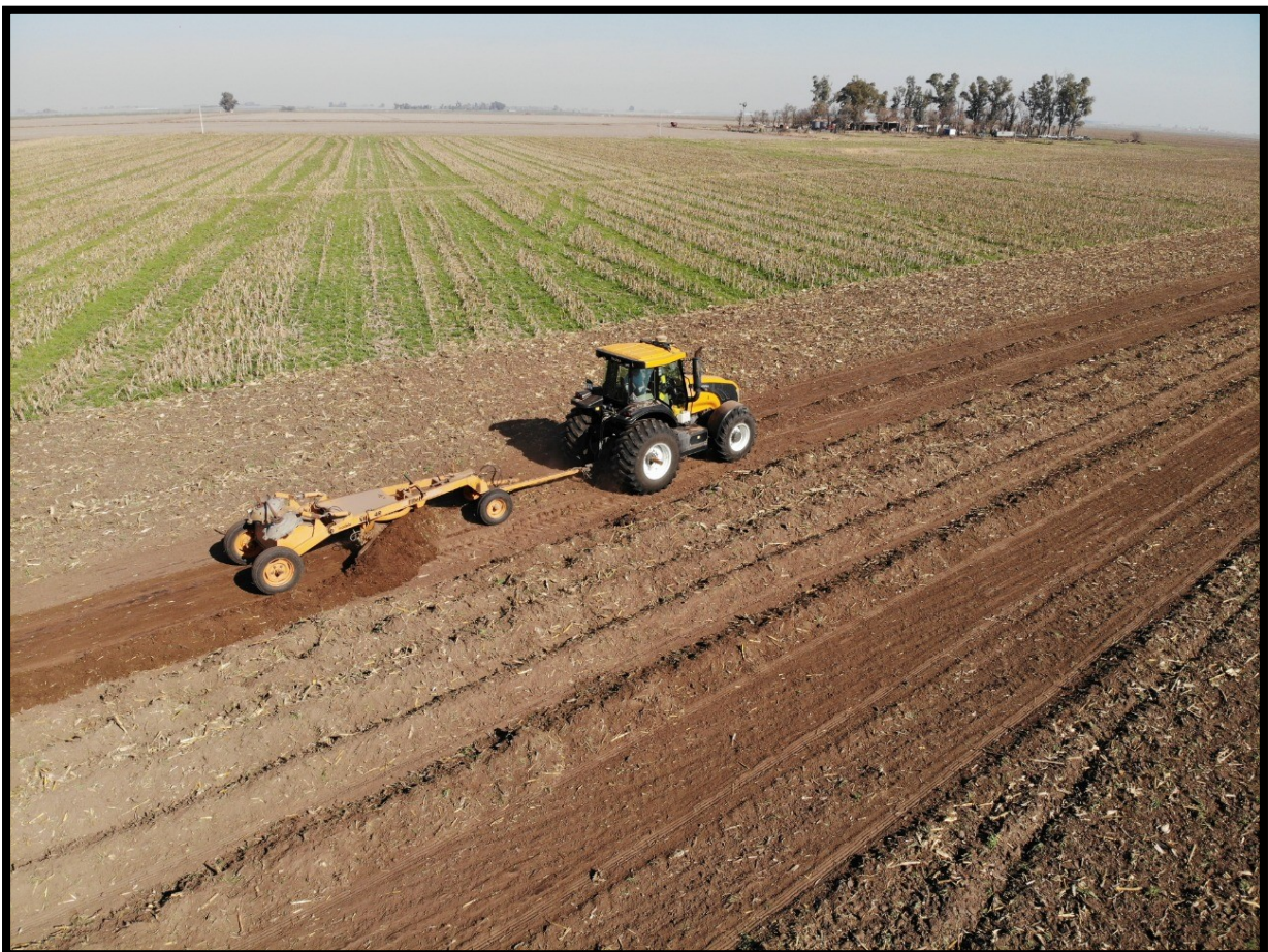
Fotografía 10. Niveladora trabajando en la construcción de terrazas de base ancha en la cuenca Brugnaro
