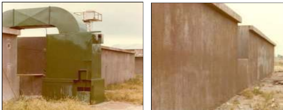
Figura 13 - Vista externa de túneles tipo "fruteros" con fuente de calor a contra corriente
