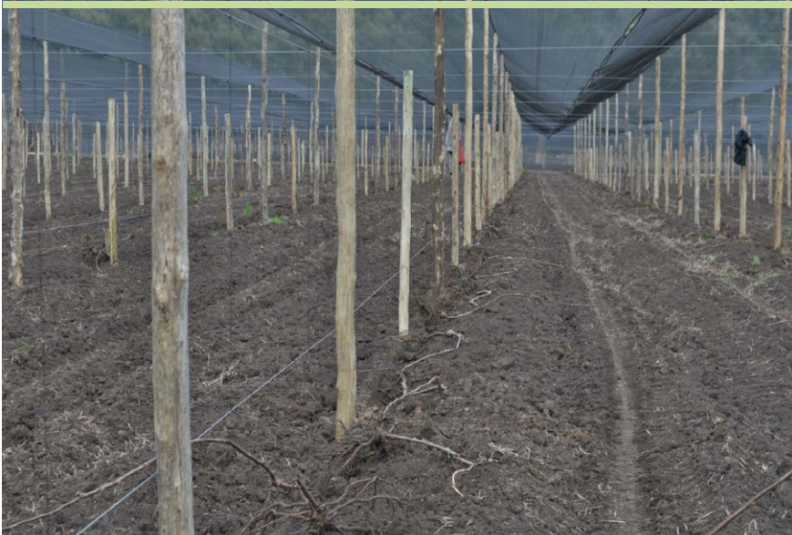
Figura 17. Lote de kiwi en preparación. Se observa la instalación de los techos y cortinas artificiales.
