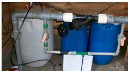
Foto 15: Sistema Venturi para inyección de solución madre
