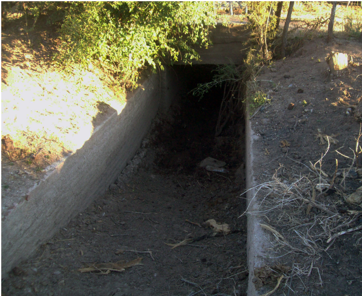
Fotografía N° 4. Toma de agua descalzada y de base de suelo arenoso
