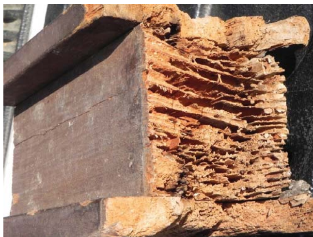
Figura 5. Viga de madera atacada por termitas.
