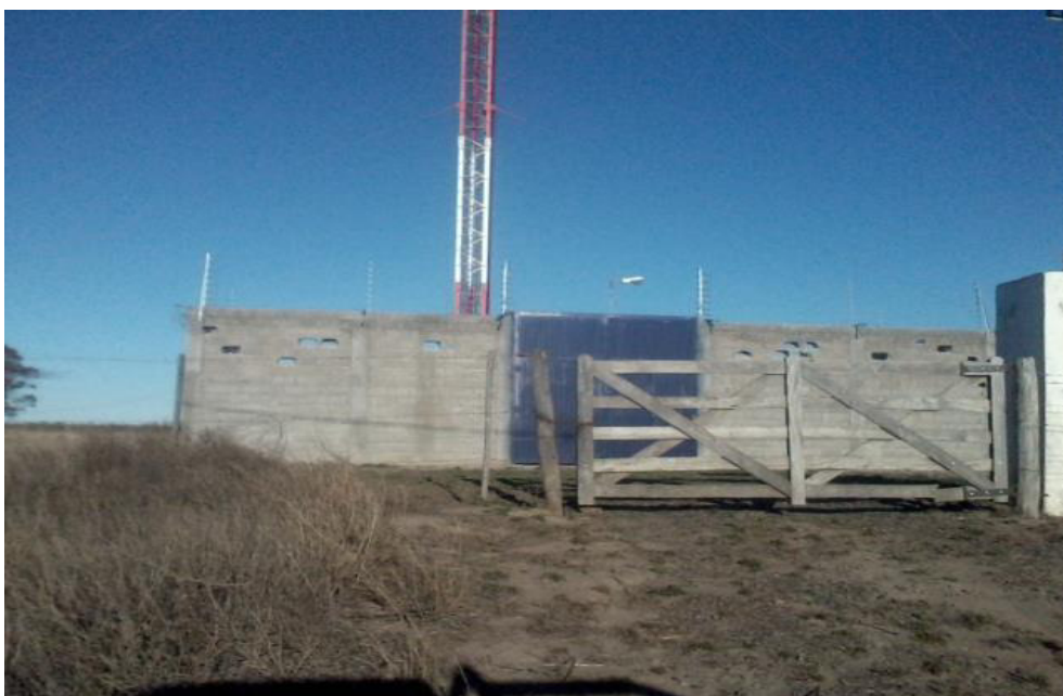
Foto 2: Perforaciones en paredes de bloques de cemento realizada por el loro barranquero en una infraestructura de telecomunicaciones. J.A. Pradere, Bs.As. (Sanchez Paolo).
