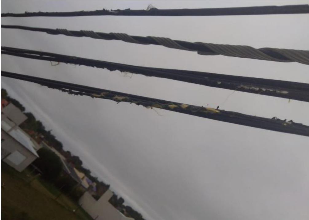
Foto 7: Daño al tendido eléctrico en Pedro Luro por loro barranquero, 2018 ( www.labrujula24.com )
