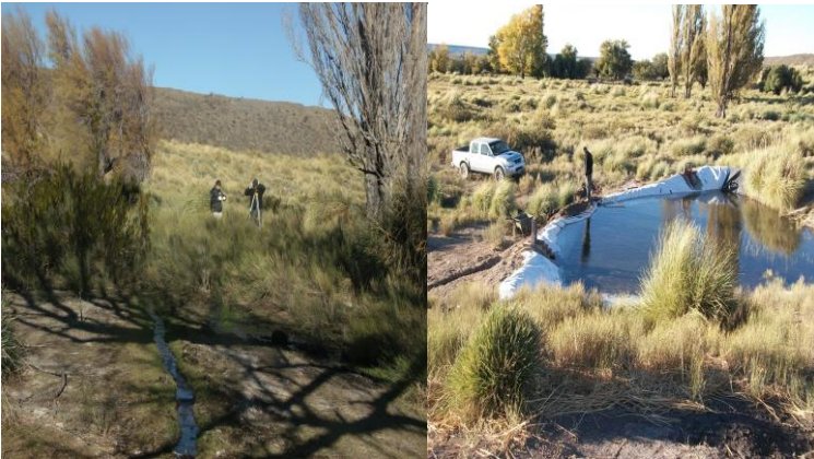
Figura..... Medición del nivel del terreno con Teodolito para trazado de acequias (Izquierda). Represa completa de agua funcionando como prueba piloto (Derecha).
