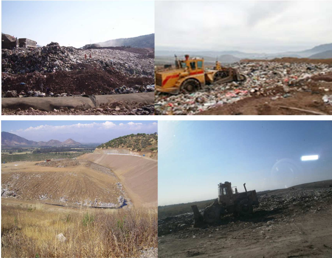
Figura 5. De izquierda a derecha y de arriba hacia abajo. Relleno sanitario en actividad, disponiendo y compactando. Etapa de relleno sanitario completada mostrando los taludes y el trabajo de la máquina de mantenimiento de la superficie.
