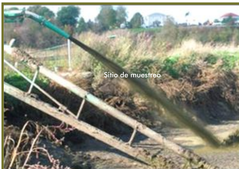
Figura 16. Bomba agitadora y de carga del efluente. No dispone de un muestreador automático y el muestreo se realiza sobre el chorro.
