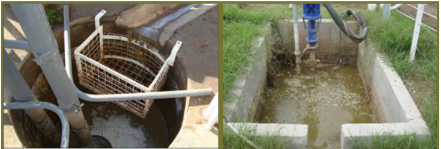
Figura 1. Cámaras con bomba estercolera, para la recolección de los efluentes provenientes de las instalaciones de ordeño.
