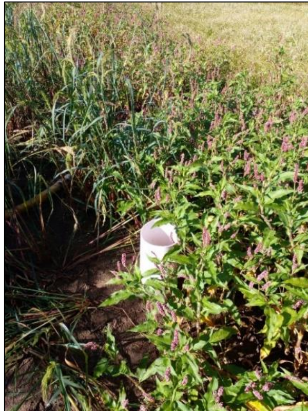
Perforación adicional al lado de la represa para futuro sistema de bombeo complementario.
