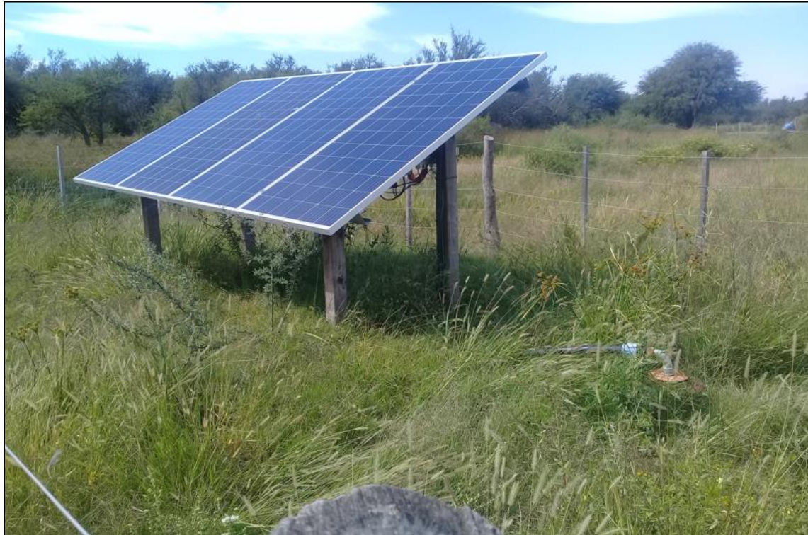
4 paneles que alimentan a la electrobomba sumergible
