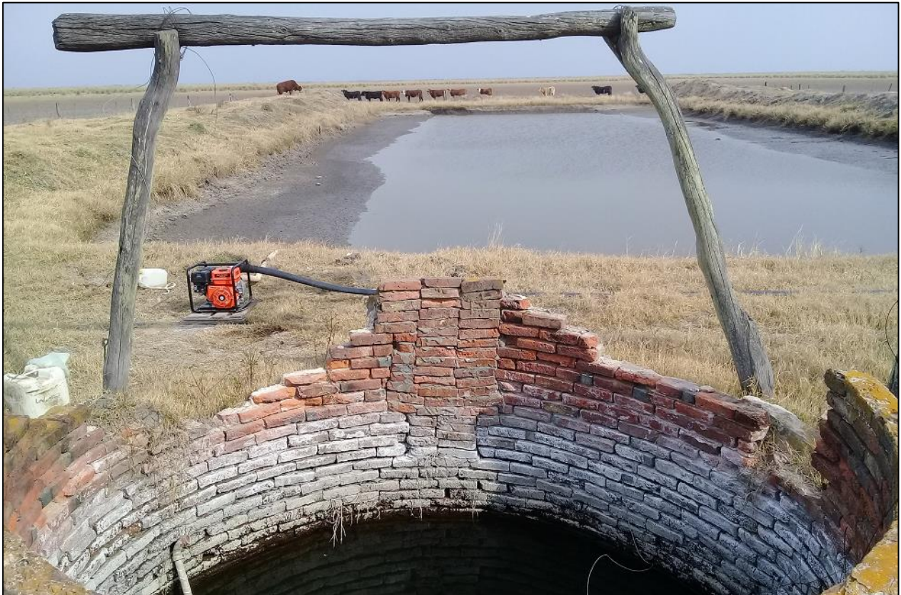
Pozo calzado que se descarta y represa al fondo de 3,5 metros de profundidad.
