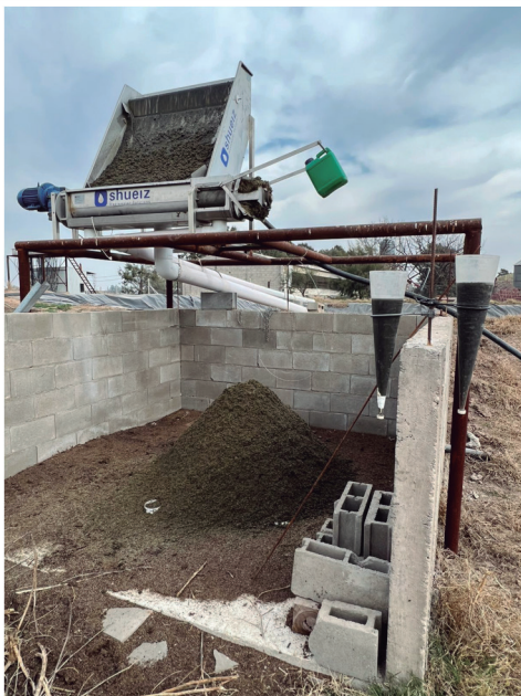
F4 Figura 4. Separador de sólidos: Tamiz y tornillo.
