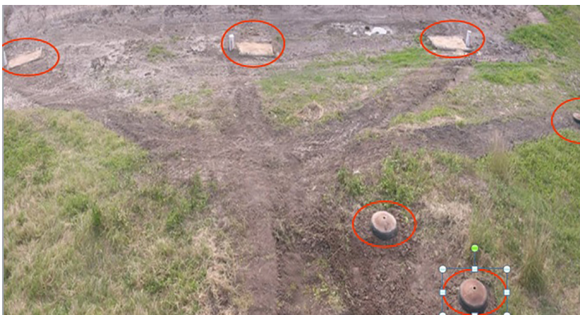
Figura 8. Disposición actual de las perforaciones doble propósito en el interior de la represa.
