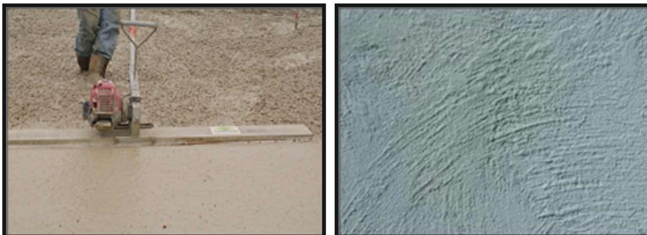
Figura 18. Terminación del hormigón fresco con fratás de madera. Foto izq: fratás de mango largo con vibrador incorporado (Fuente: GIE Lait-Viande de Bretagne, 2010). Foto der.: acabado logrado con fratás de mano (terminación a muñeca).
