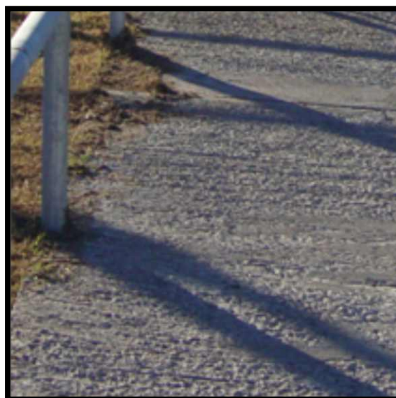
Figura 19. Superficie reglada con madera sobre hormigón fresco, sin llanear. Terminación rugosa no recomendada. (Fuente: INTA).
