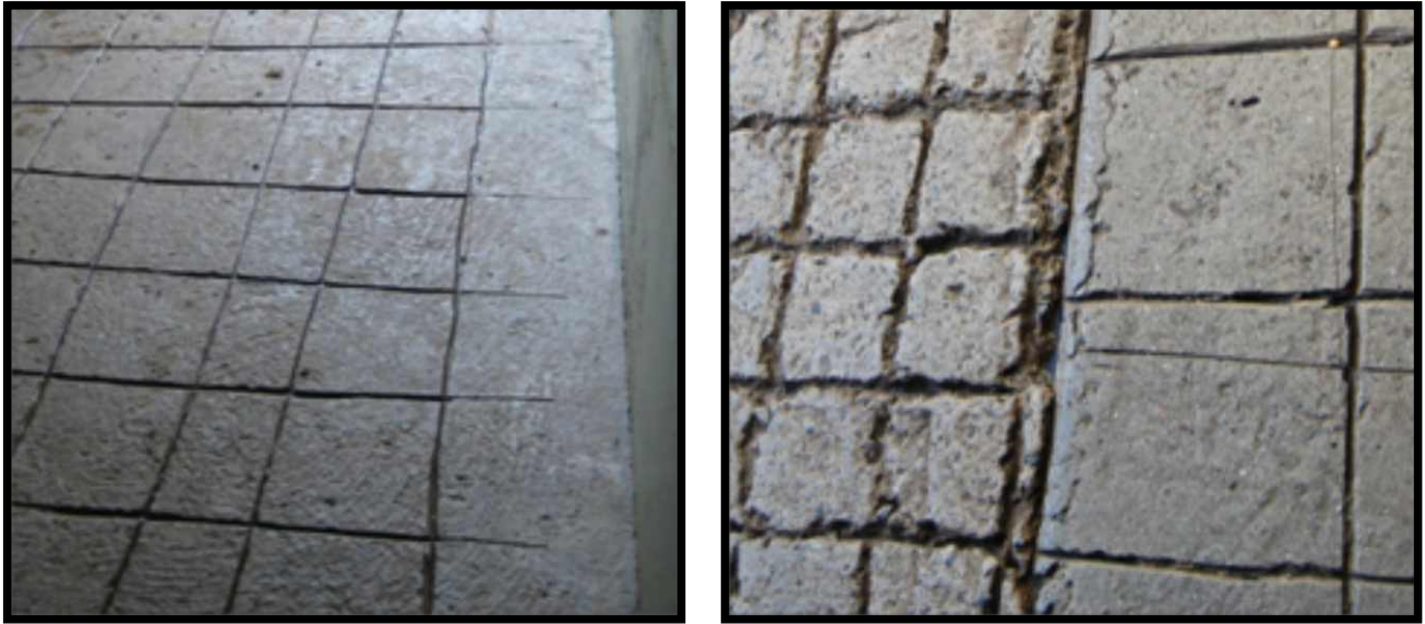
Figura 39. Ranurado con amoladora de mano, desprolijo y muy poco efectivo para evitar la caída de vacas.
