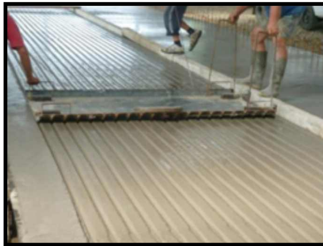
Figura 29. Ranurado paralelo en hormigón fresco utilizando molde metálico. En este caso, el diseño es de 10 cm entre línea, 2,0 cm de ancho y 1,0 cm de profundidad. (Foto Azienda Agricola ZAMBIANCHI).
