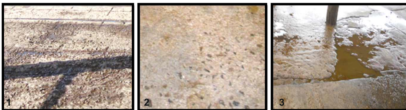
Figura 1. Exposición de los agregados debido a la pérdida de la pasta de cemento en corral espera.
