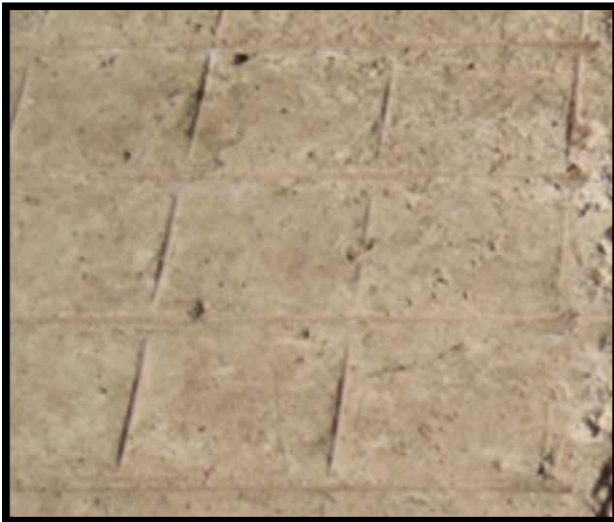
Figura 37. Ranurado por estampado de malla de acero en Sala de Ordeño. El espaciamiento entre surcos, ancho y profundidad no son adecuados.
