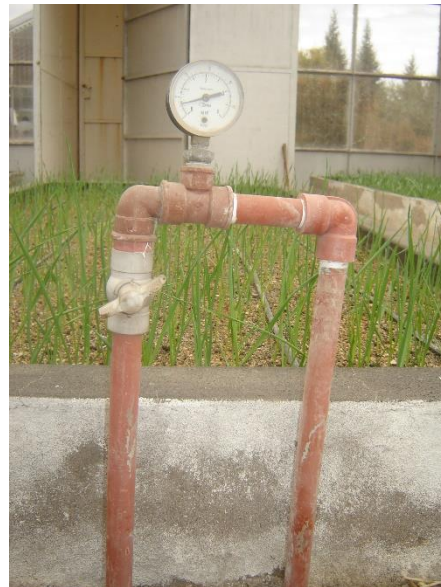
Figura 14 – Detalle de manómetro
