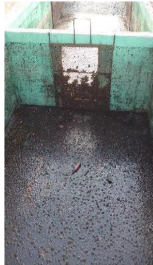
Figura 142. Pileta de sedimentación colmatada
