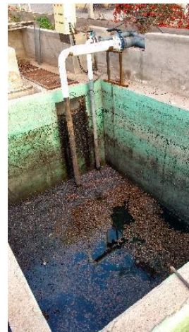
Figura 138. Segunda cámara sedimentadora y bomba
