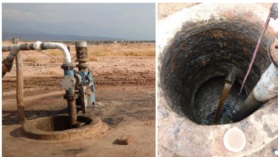
Figura 115 y 116. Cámara donde confluyen efluentes de la fábrica de maquinado y de aceite de oliva
