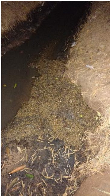
Figura 96. Sólidos en el canal de evacuación
