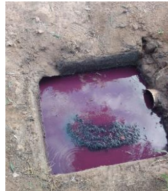
Figura 68. Cámara tapada con orujo
