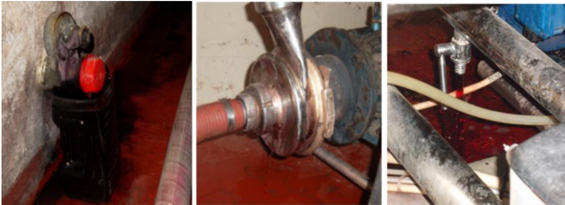
Figura 59. Pérdidas de producto en instalaciones
