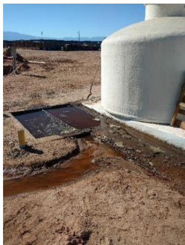
Figura 118. Rebalse de efluente en cámaras.
