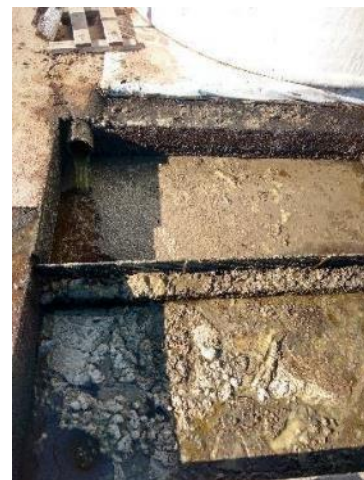
Figura 120. Acumulación de grasas y sólidos en cámara.
