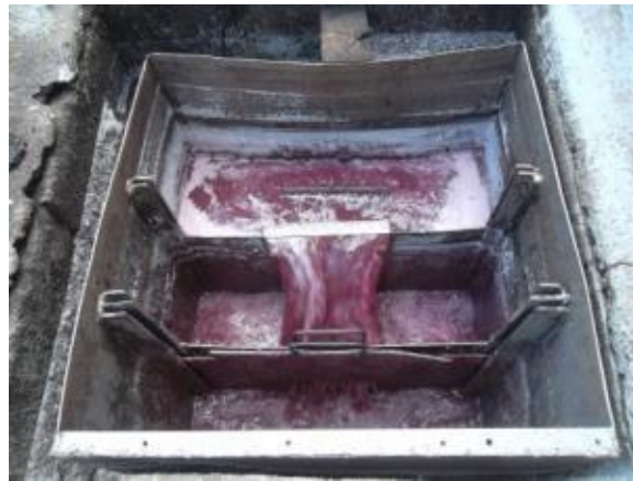
Figura 16. Aforador triangular 60^\circ en cámara de aforo
