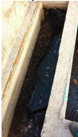
Figura 141. Acumulación de sólidos y barro en canaleta
