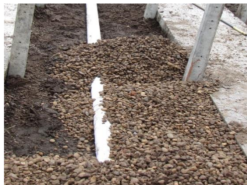
Figura 2: Caminos de hormigón y área bajo las mesadas con caños perforados para desagüe y canto rodado lavado.
