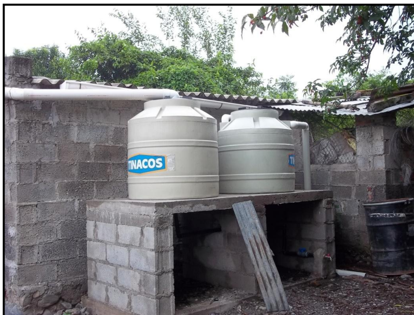
Figura 3: La tecnología utilizada en Francia se utiliza también en esta HGFU en Jujuy. Puede verse como se “cosecha agua de lluvia”, con un sencillo sistema de canaletas y desagües hacia unos tanques de reserva. Esta es una HGFU visitada en V° Jardín de Reyes (casa de Isabel).
