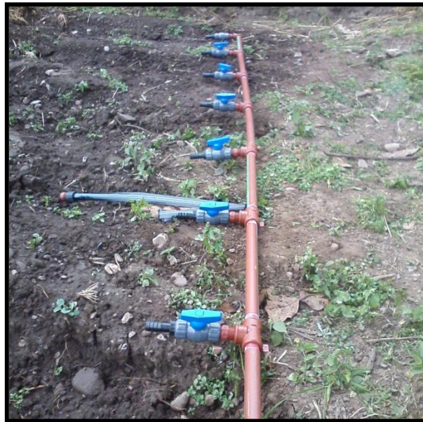
Figura 21: En esta fotografía puede observarse una línea secundaria de riego localizado (goteo). Se ven claramente la cañería y las válvulas. Lo llamativo es que los materiales han sido adaptados al uso agrícola, ya que éstos que se ven en la foto son normalmente los utilizados en instalaciones de plomería para viviendas. Este módulo de riego surtía agua a una parcela de cultivos hortícolas de 50 m 2 . Su constructor es de oficio plomero.
