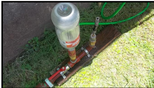
Figura 28: Una vista de la bomba de ariete. Puede verse la cámara de presión y las dos válvulas de retorno. Todo el conjunto está montado sobre un taco de madera para quedar en posición vertical.
