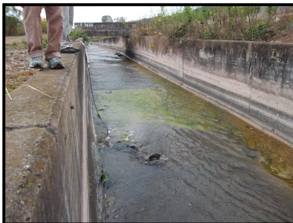
Figura 34: Este canal lleva miles de litros de agua por minuto. Es agua apta para riego y se extrae con un ingenioso mecanismo de sifón. Puede verse en la pared izquierda del canal la manguera que lleva agua a la HGFU.
