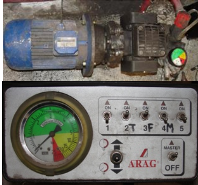
Figura 19: Vista parcial del comando de pulverización y bomba.
