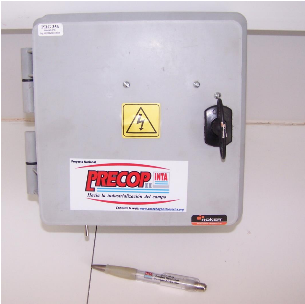
Figura 4. Imagen del controlador de aireación cerrado, donde se aprecia el detalle del tipo de gabinete utilizado.
