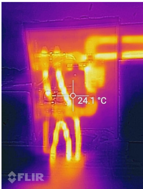
Imagen 18. Termografía del tablero de imagen anterior. Foto: N. Di Ruscio
