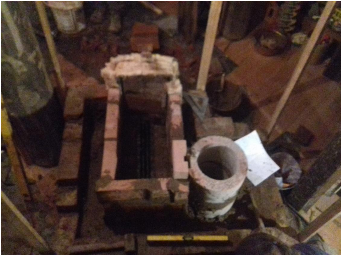
Imagen 28. Estufa BBR8L en construcción. Torreta en pre moldeado refractario. Ing. Maschwitz, Pcia. De Buenos Aires. Foto: P. Kulbaba
