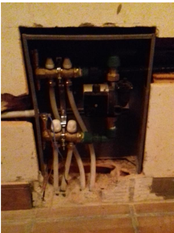
Imagen 17. Estufa BBR8 con sistema de agua de calefacción. Tablero de mandadas y retornos. Foto: P. Kulbaba
