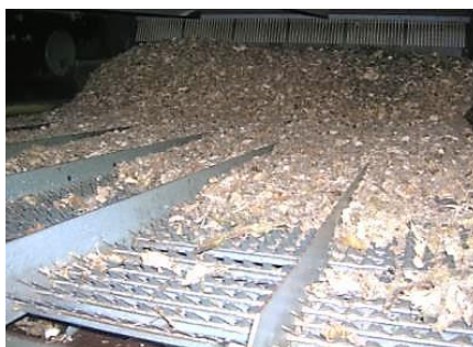
Figura 17. Obsérvese la saturación de material muy desmenuzado, colapsando la zaranda superior.
