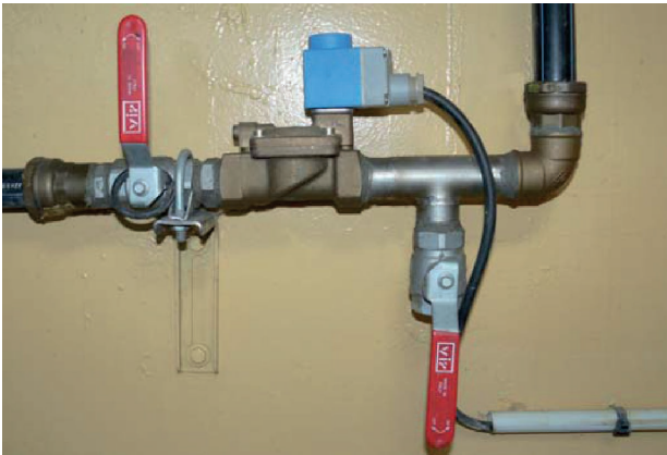
Figura 5. Electroválvula ubicada sobre cañería de agua (GIE Lait-Viande de Bretagne – Institut de l'Élevage, 2010).
