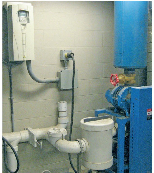
Figura 15. Controladores de velocidad variable instalados en bomba de vacío.
