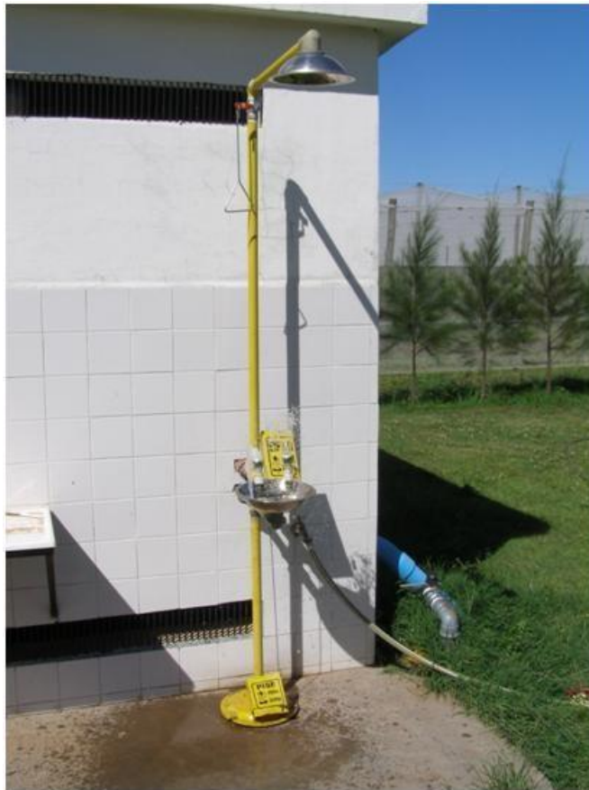
Foto 2: ducha y lavaojos ubicado a la salida del almacén de agroquímicos. Observe las rejillas para la ventilación natural.
