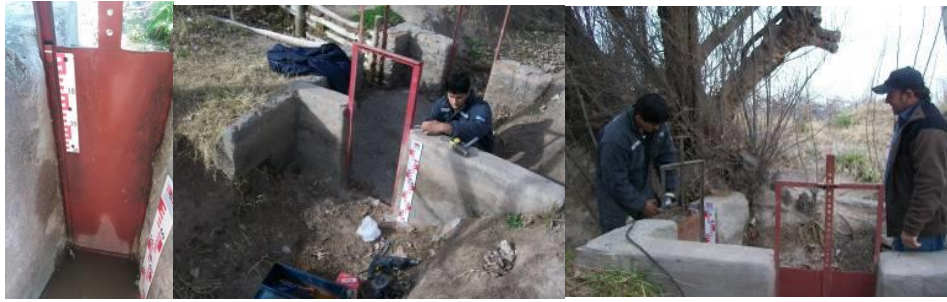
Fotos N° 1, 2 y 3: instalación a campo de escalas plásticas con graduación, para medición de caudal.
