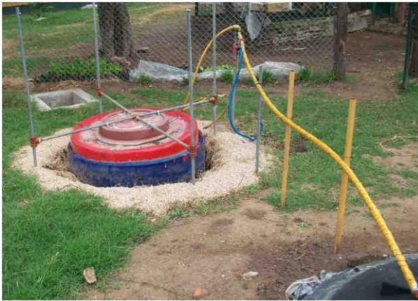
Figura 34 – Conexión de biogás desde el digestor al gasómetro.
