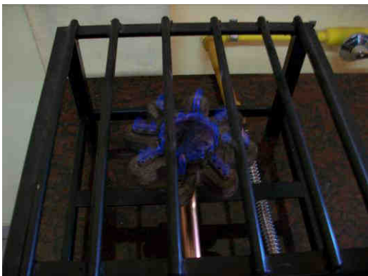
Figura 40 – Quemador de biogás en funcionamiento.
