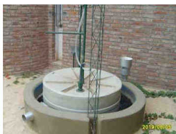
Figura 1 Gasómetro del tipo “Campana flotante”. Imagen gentileza Orlando Giampaoli
