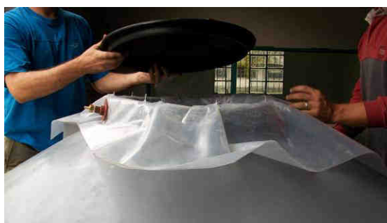
Figura 15 – Colocación de silicona y nylon para evitar fugas de biogás.
