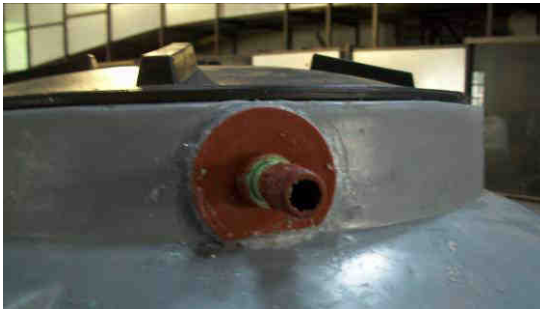
Figura 10 – Salida de biogás del biodigestor.
