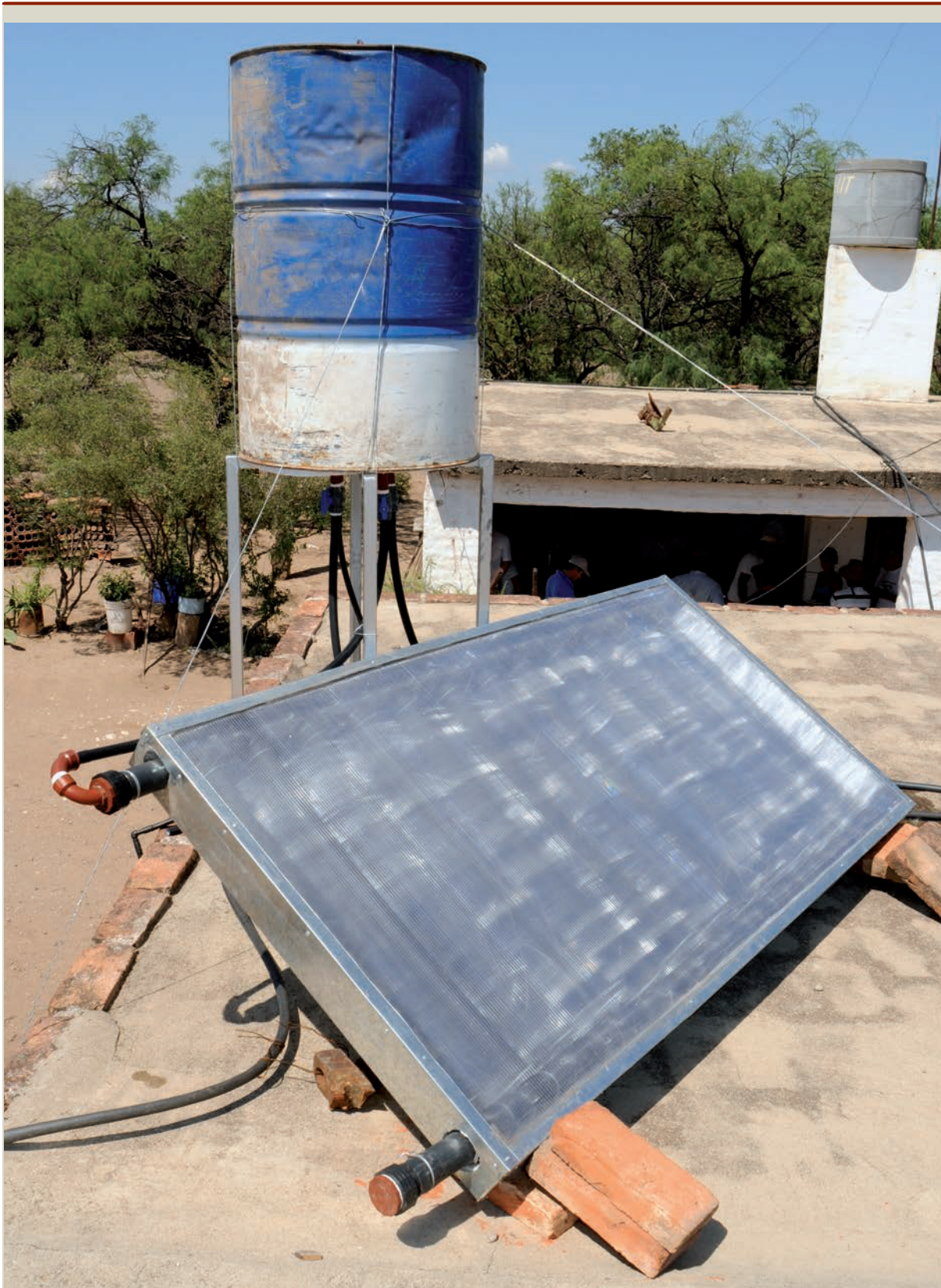
Termotanque solar de autoconstrucción en tambos caprinos del norte de Córdoba.
