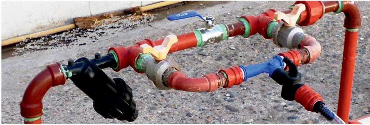
Detalle del dispositivo de inyección de fertilizante mediante un venturi
