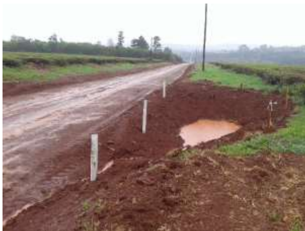
Imagen 10. Canal de derivación y pozo de decantación en camino terrado. Campo Viera. Misiones
