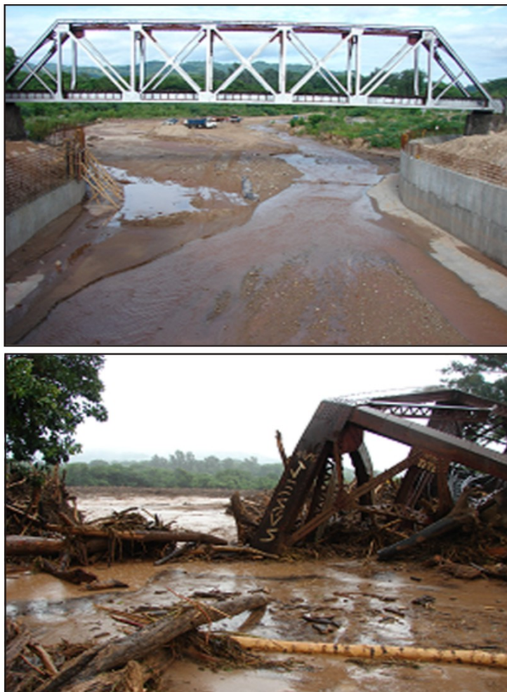
Figura 15. El Alud en Tartagal (Salta). Vista del puente ferroviario sobre el río Tartagal, antes y después de sucedido el fenómeno. (Fotos: Miguel Boasso, AER Tartagal, INTA, Pro Huerta).
