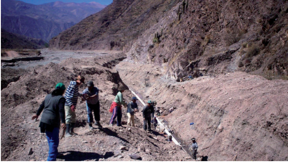
Fotografía 4. Construcción del sistema de captación de agua. La mano de obra fue aportada por los integrantes de la comunidad y el financiamiento por organizaciones externas. Foto: Roberto Cruz.
