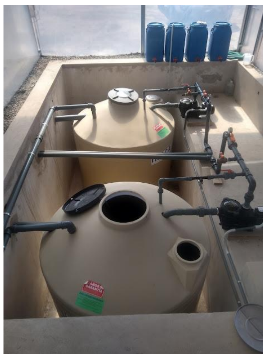
Figura 3.4: Tanques de 3000 L
