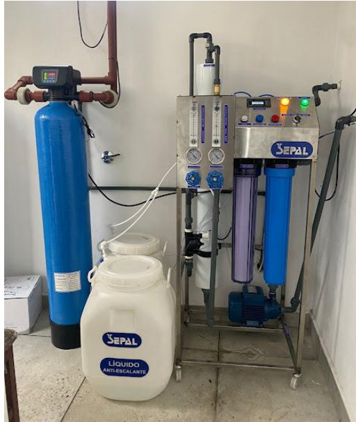
Figura 4.4: Equipo de ósmosis inversa
