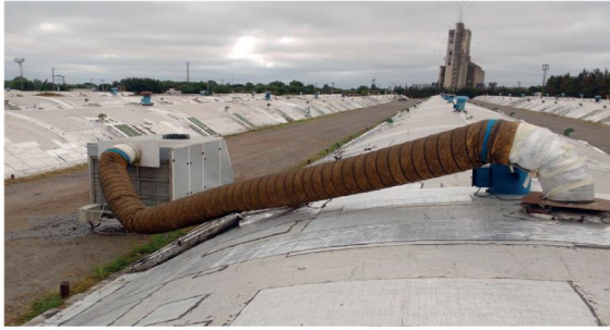
Vista en detalle de la conexión entre el refrigerador y el silo subterráneo.
