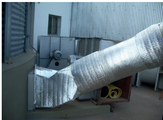
Figura 25. Aislamiento del conducto y transición de entrada de aire a la boca de aireación del silo.
