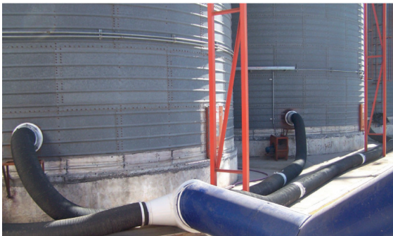
Figura 8. Conexión para el enfriamiento en simultáneo de dos silos.
