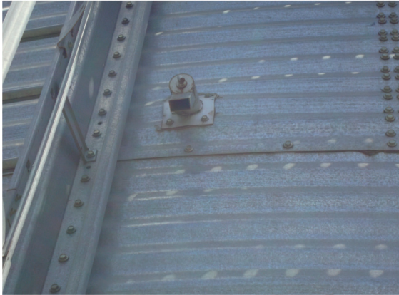
Figura 20. Boquilla lateral en un silo.
