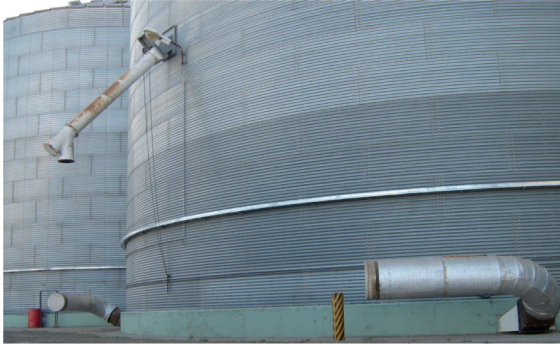
Figura 14. Conexiones fijas para acoplar el equipo refrigerador al silo con conductos de aireación previamente dimensionados.
