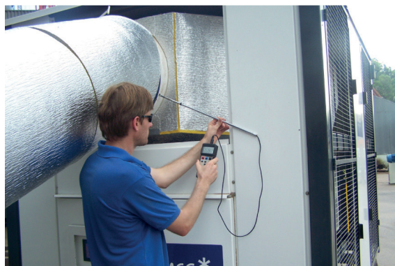
Figura 27. Medición de temperatura del aire a la salida del equipo de frío.
