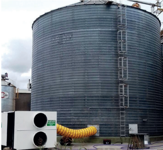
Figura 6. Conexión del equipo de frío a un silo.
