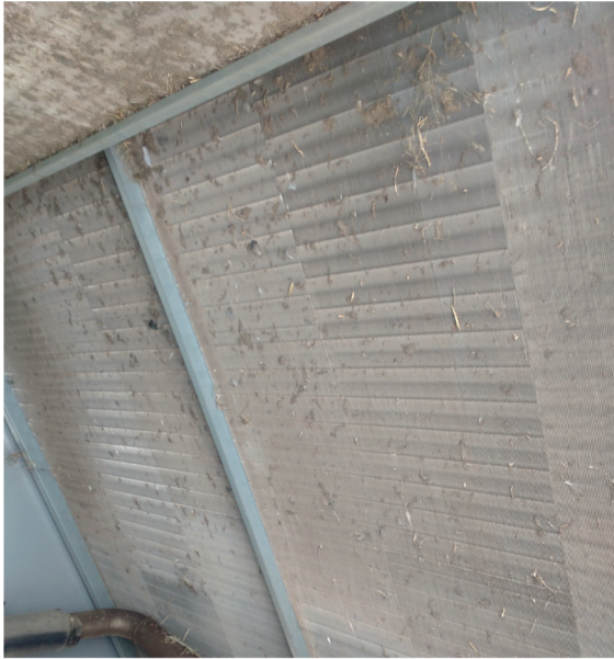
Figura 5. Condensadores del refrigerador con depósito de tierra que disminuye su eficiencia de funcionamiento.
