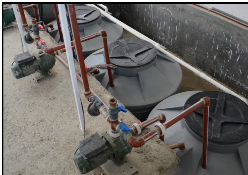
Figura N°2. Detalle del sistema de bombeo instalado en el invernadero hidropónico en NFT.
