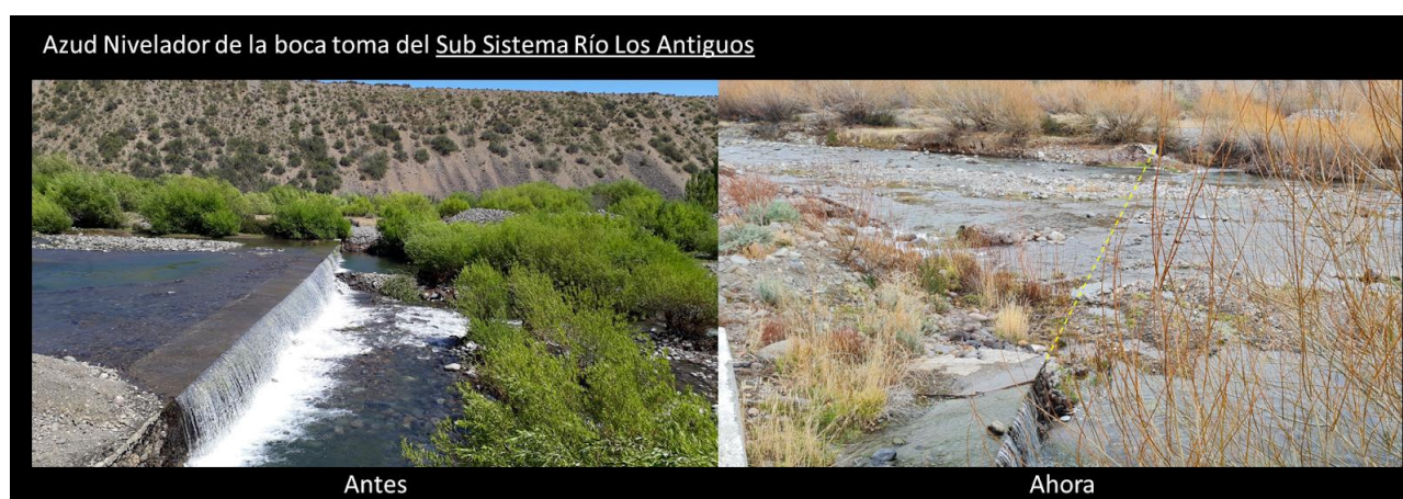
Foto 1. Estado actual del azud nivelador sobre el río Los Antiguos (der) y el azud funcionando adecuadamente en el pasado (izq).
