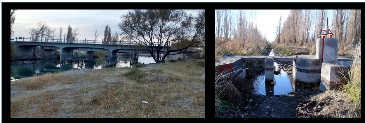
Foto 4. Obras en el valle de Sarmiento. (izq.: puente Abait; der: obra en canal comunero).
