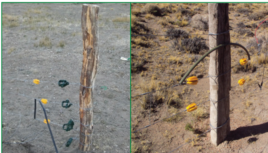
Imagen 6: Postes atadores, importantes para tensar el alambre, con torniquetas y luego aisladores en la foto de la izquierda y con aisladores en la foto de la derecha.
