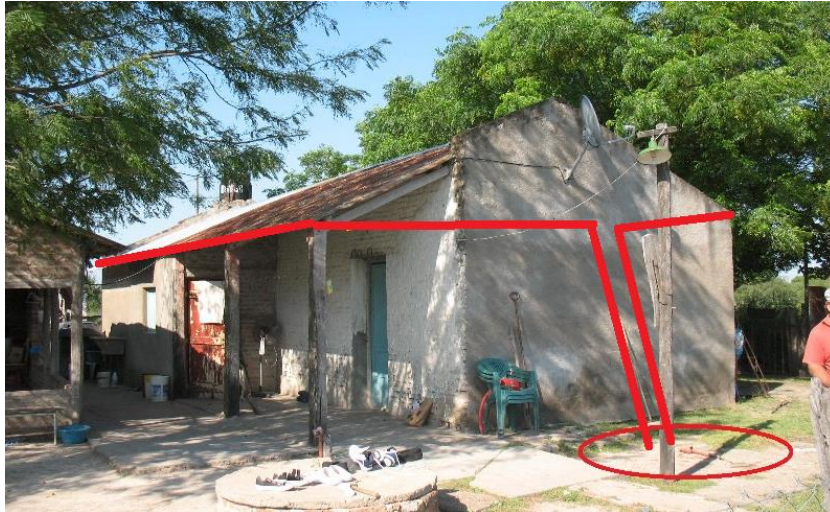
Ubicación aljibe en la zona norte de la casa con 2 sistemas de canaletas.
