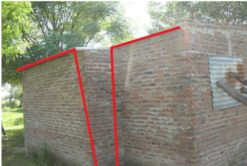
Las canaletas deben contemplar la forma del techo en la zona oeste de la casa.
