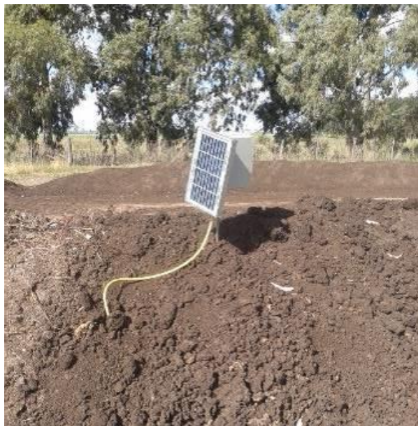
Figura 19. Sistema de sensores con telemetría en pila de compost.
