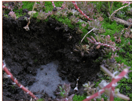
Figura 12. Techo verde con un sustrato formulado con 100% suelo mineral. Se observa el poco desarrollo de las plantas, presencia de malezas y el avance de musgos.
