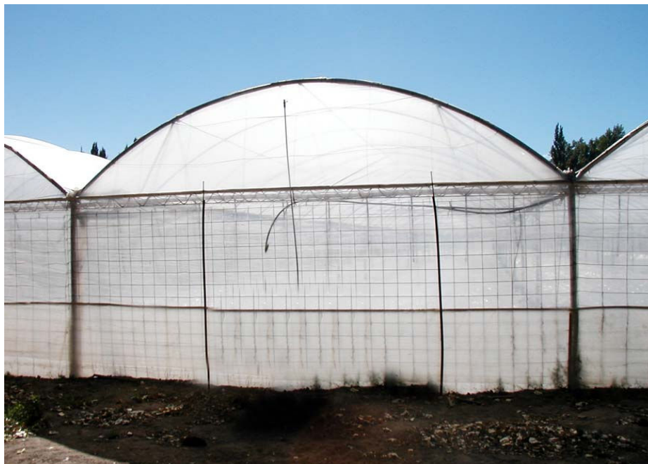
Figura 4.5: Vista frontal de un cuerpo de un invernadero de techo semi parabólico de cubierta simple.
